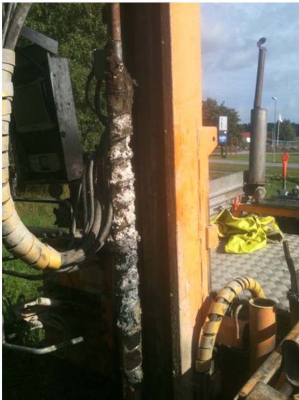
Figur 3. Gipsrester kvar på borrarutrustningen
