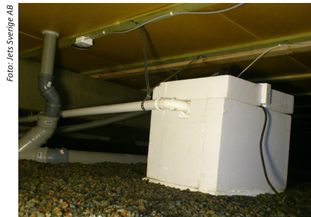
Isolerad vakuumenhet i krypgrund.
