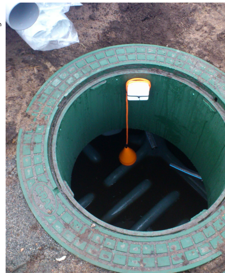
Tank med larmvippa och anslutna ledningar.
